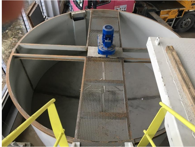
Şekil 18. Çamur Karıştırıcı tanklar.
