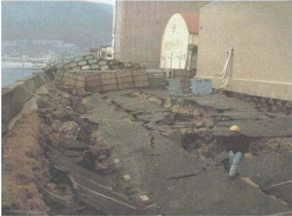
Şekil 13. 1995 Kobe depreminde sıvılaşma sonucu oluşan istinat duvarı yenilmesi.
