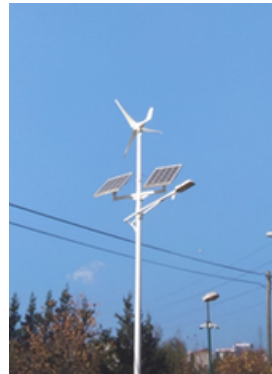
Rüzgar ve Güneş Enerjisi paneli Aydınlatma Örneği
