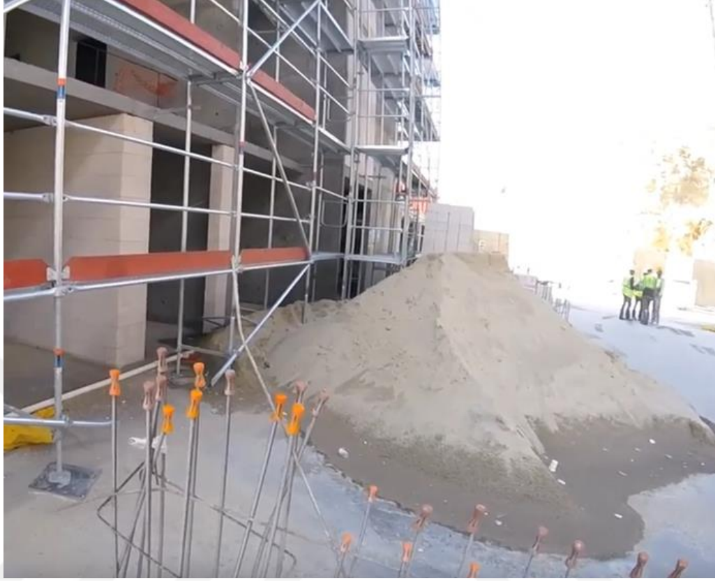
Şekil 48. İskele önünde, etrafında malzeme istifleri ve çevresinde çalışanların güvenliği
