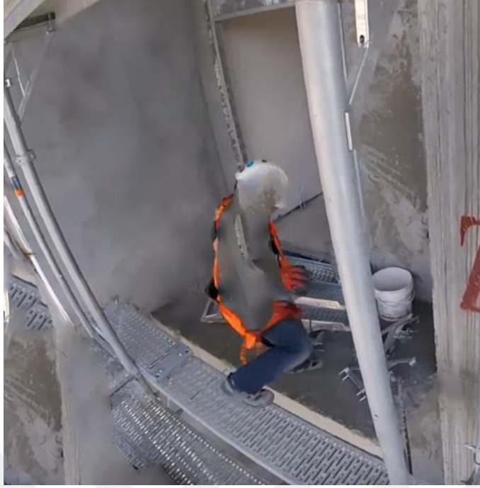
Şekil 49. İskeleden yapıya uygunsuz bir geçiş
