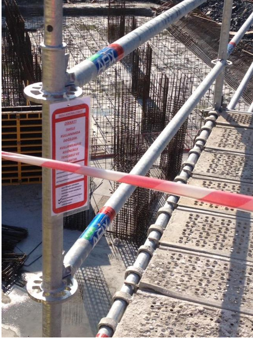
Şekil 60. İskele kontrolü sonucu kullanım dışı bir iskele
