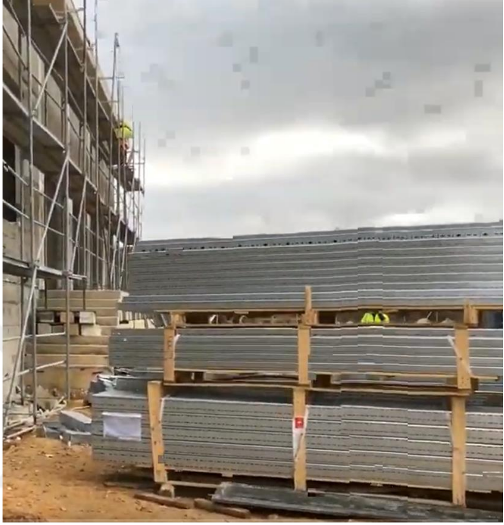
Şekil 55. İskele ekipmanları ve malzemelerin uygun şekilde istif edilmesi
