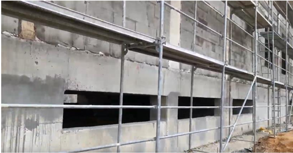
Şekil 52. Korkuluk sisteminde topuk levhalarının eksik olması
