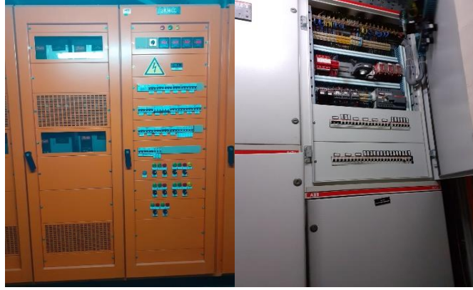
Resim 4. Kule yerleşkemizde bulunan MCC ve DDC panolarımız
