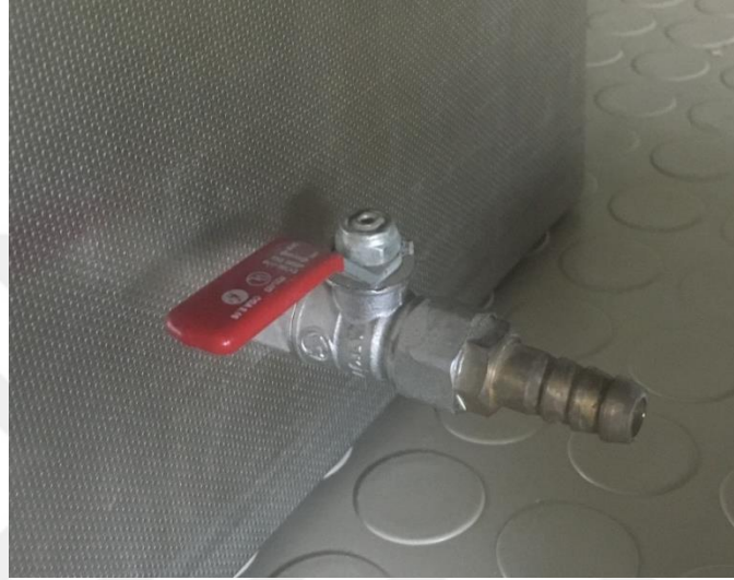
Şekil 6.17. Ultrasonik temizleme yapılan tankın sıvı tahliye vanası
