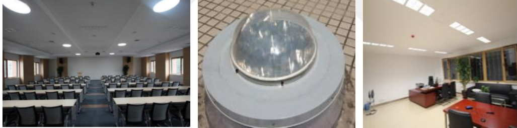
Şekil 26. NZE' ye ait CABR ofis binası konferans salonu (solda), tavanda ışık tüpü ile doğal aydınlatmanın sağlanması (orta), ofiste LED tavan aydınlatması (sağda) (Xu, 2018)
