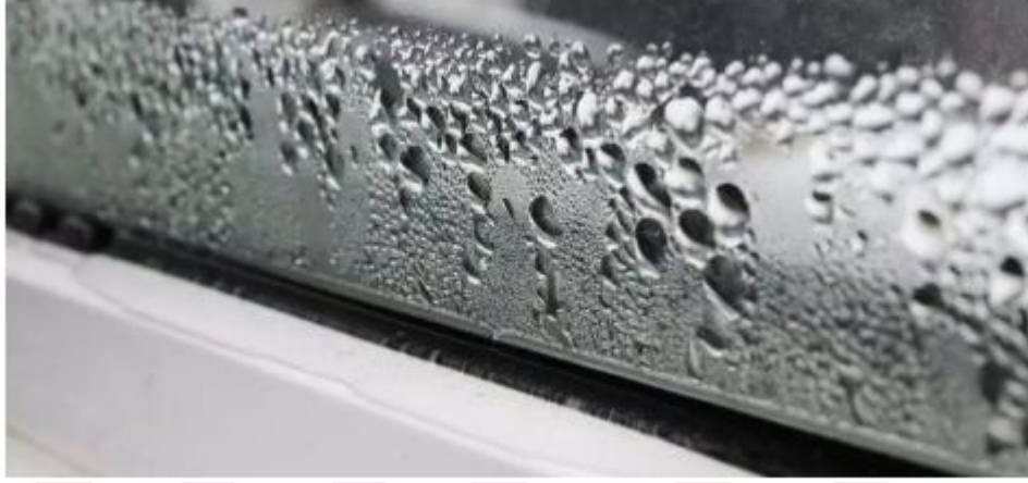
Şekil 31. Giydirmce cephede yoğuşma örneği ("Alüminyum cephe ve pencere", 2025)
