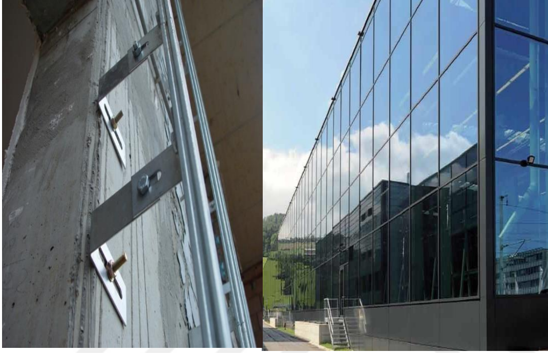
Şekil 29. Duvara ankrajlanmış giydirme cepheyi ayakta tutan ana iskelet karkas ve imalatı tamamlanmış giydirme cephe
