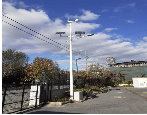
Resim 5. D blok güneş ve rüzgar enerjisi ile çalışan çevre aydınlatma direği
