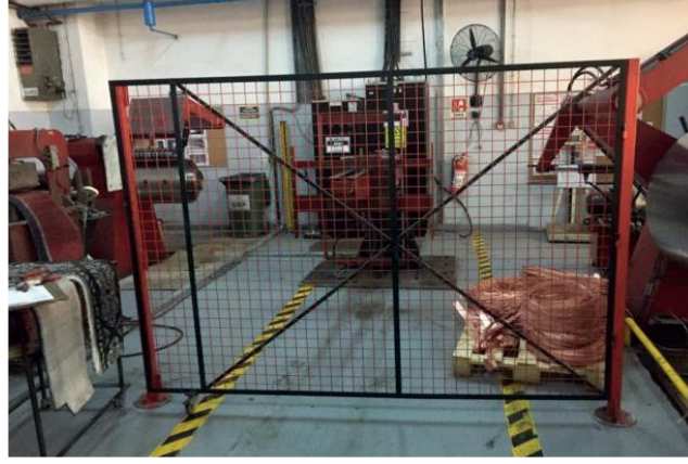
Resim 10. Dilme makinasında operasyon bölgesine erişimin tel kafes yapılarak engellenmesi olumlu örnekler
