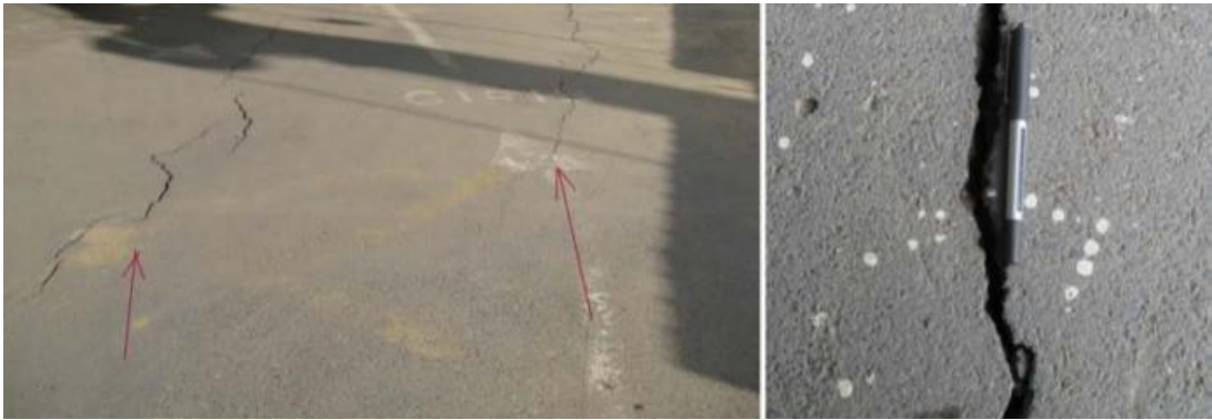
Şekil 48. Deplasmanlar sonucu oluşan yüzey çatlakları (Dayıoğlu, 2010)
