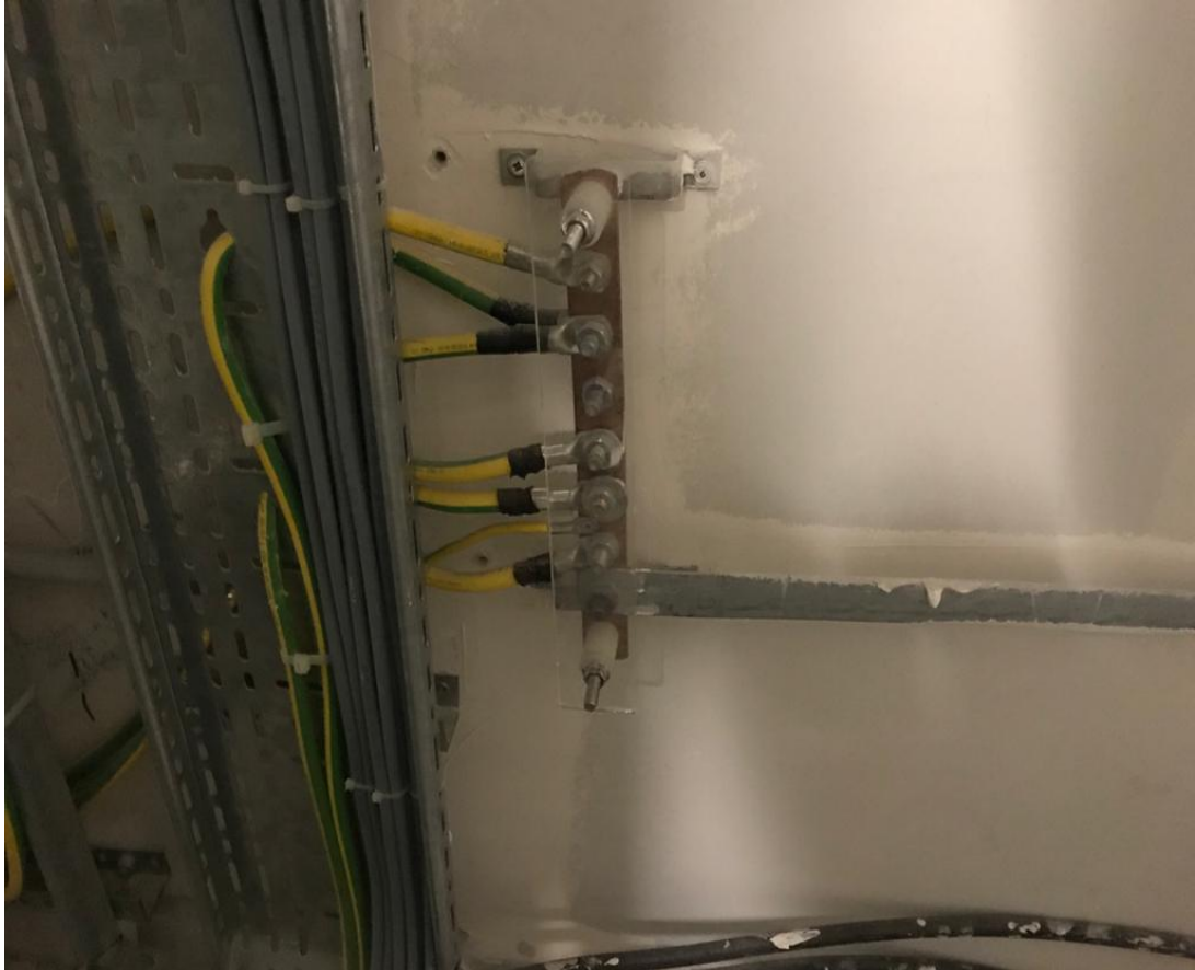
Resim 6. Elektrik odalarında eş potansiyel dengeleme barası görseli
