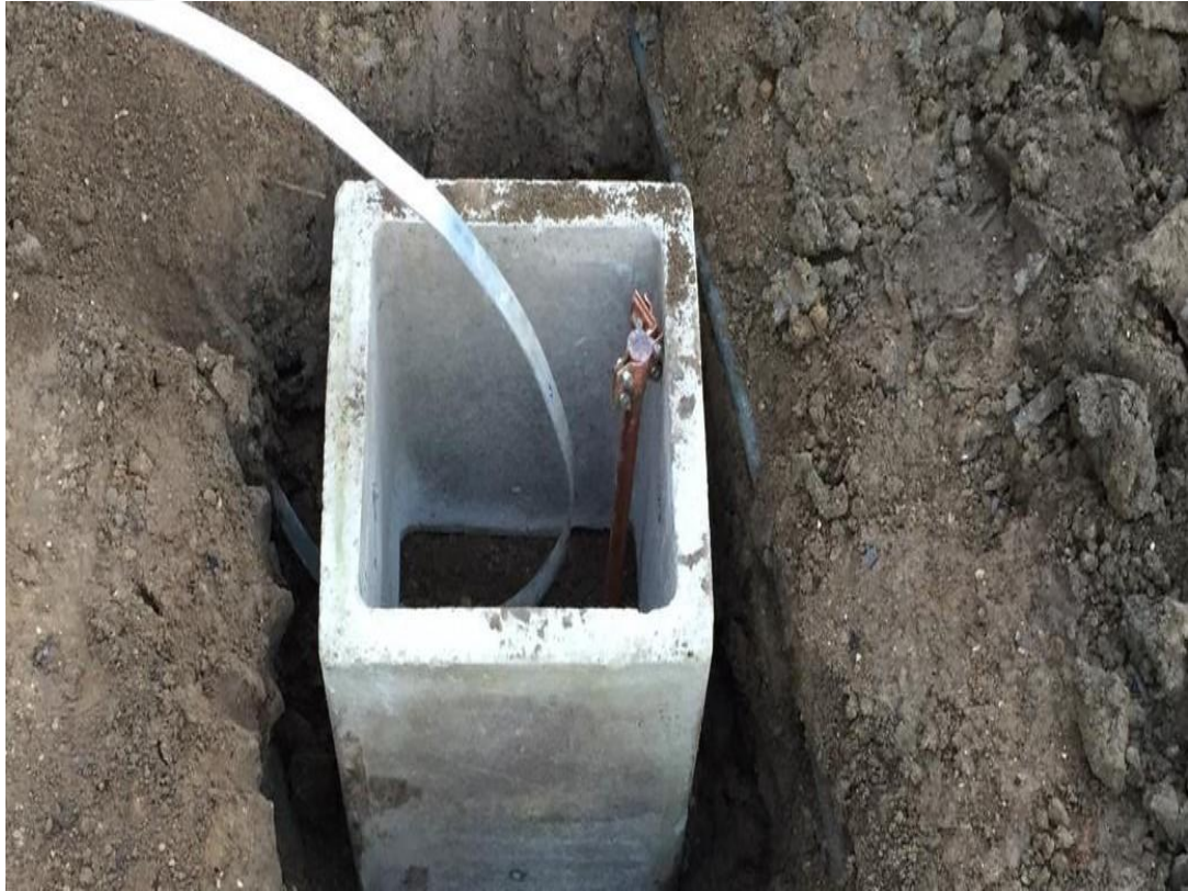
Resim 7. Bina etrafında toprak seviyesinde topraklama çubuk görseli
